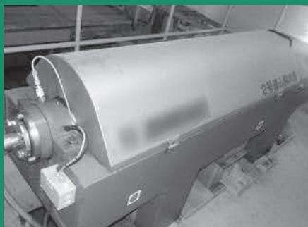
長瀬浄化センター汚泥脱水機(2号)
